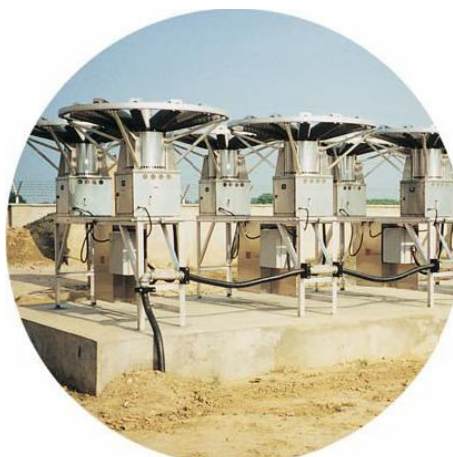
б) станція диспетчерського контролю, збору даних та катодного захисту газопроводів на території Індії
