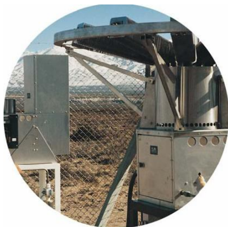
а) станція катодного захисту комунікацій в Аргентині потужністю 550 Вт
