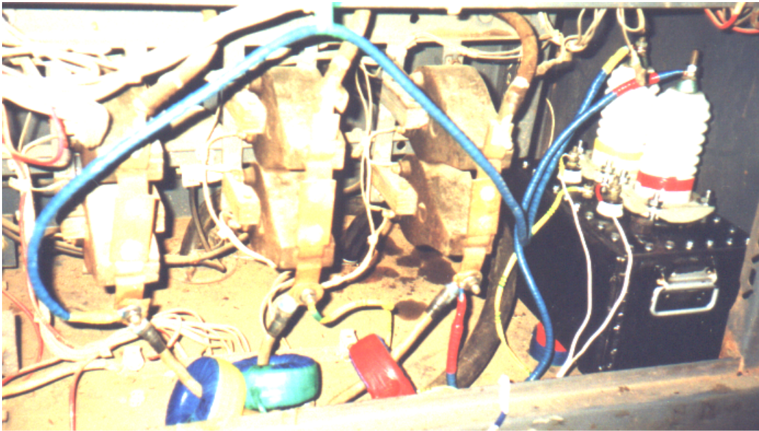
Рисунок 3 — Розміщення здавачів струму і напруги у високовольтній комірці шафи керування електробуром
