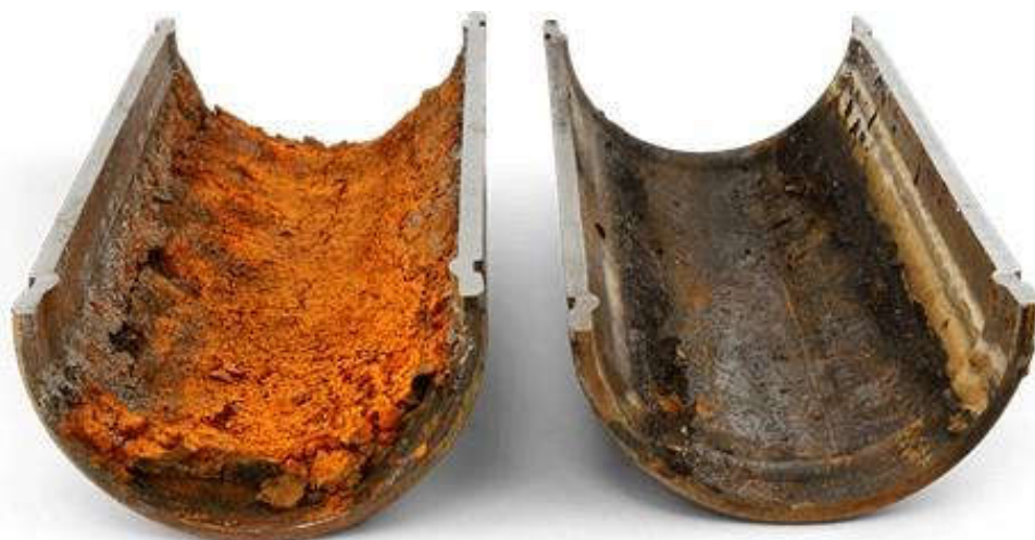
Рисунок 8 – Наслідки корозії промислових трубопроводів
